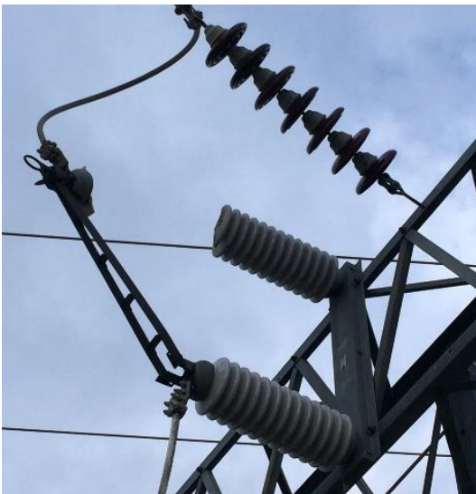
Fig. 5. Primeira falta na fase A da Chave Seccionadora S11.
